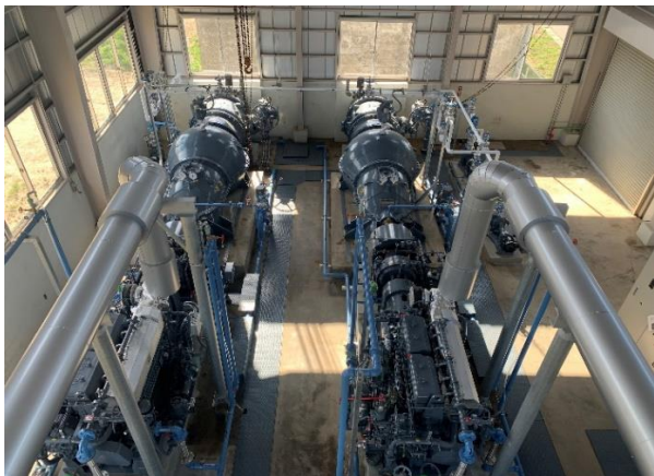
【駒留排水機場 ポンプ設備】
